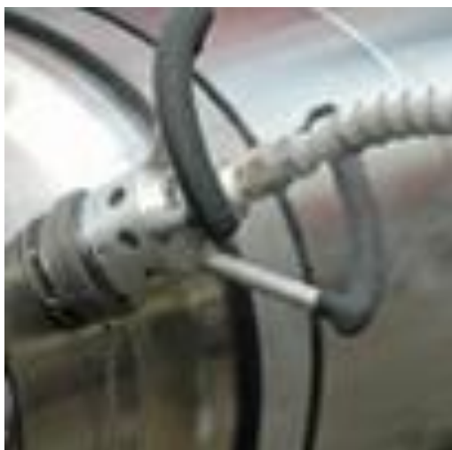
Figuur 6: Een vulpunt aansluiting; Bron Rolande LNG BV
